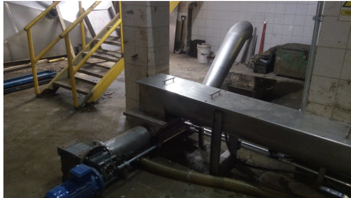
Tornillo transportador junto a tornillo compactador para proyecto “Recambio reja fina y sistema de transportación y compactación, Algarrobo”. Cliente: Esval.
