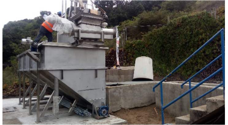
Diseño, fabricación y montaje de PPTC para planta Laguna. Cliente: ESVAL S.A.
